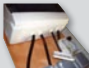
Sistem electric containere depozitare
